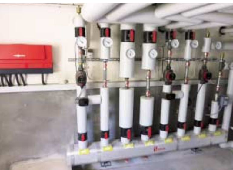
Schaffhauser Str. 56/58, Tiengen Einblick in die neue Heizzentrale - Übergabestation
